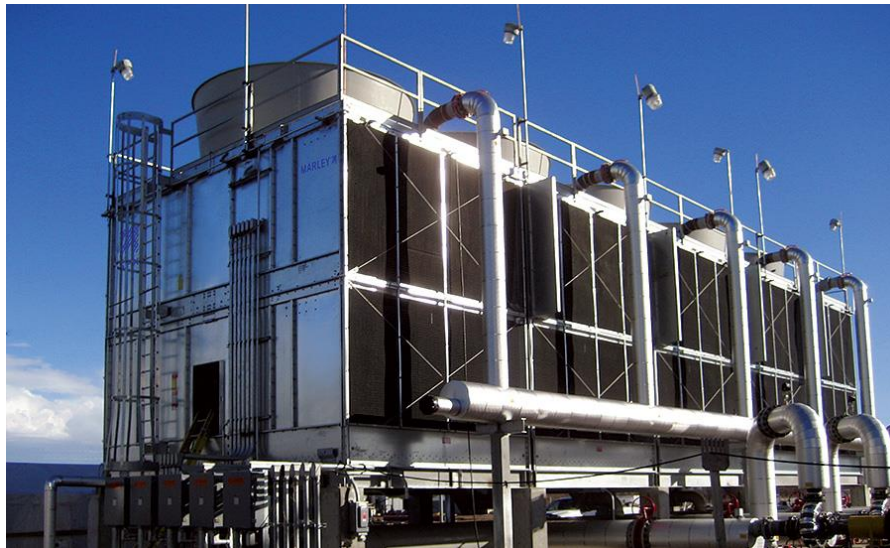
Figure I.3: Installations de traitement chimique
