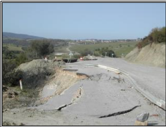
Photo 05: Glissement de la route nationale n° 02 El Tarf-Bouhadjar (Commune Ain Karma)
