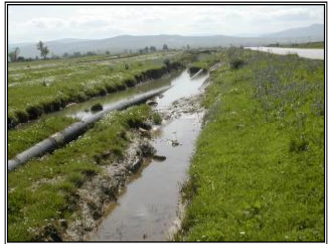
Photo n°6: Destruction de la conduite de refoulement de L'eau potable de la Commune de Cheffia par ravinement
