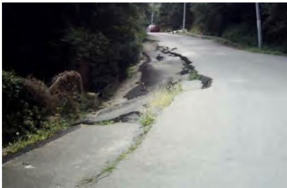
Photo 2- Risque de Glissement de terrain ( Skikda 2004)
