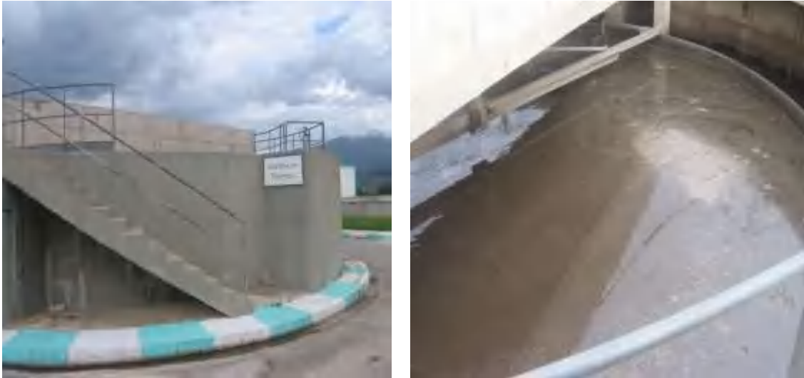
Figure 15: Dégazeur de la station de Sidi Merouane.
