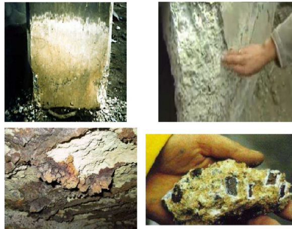
Figure I.3 Bétons dégradés par les sulfates [38]
