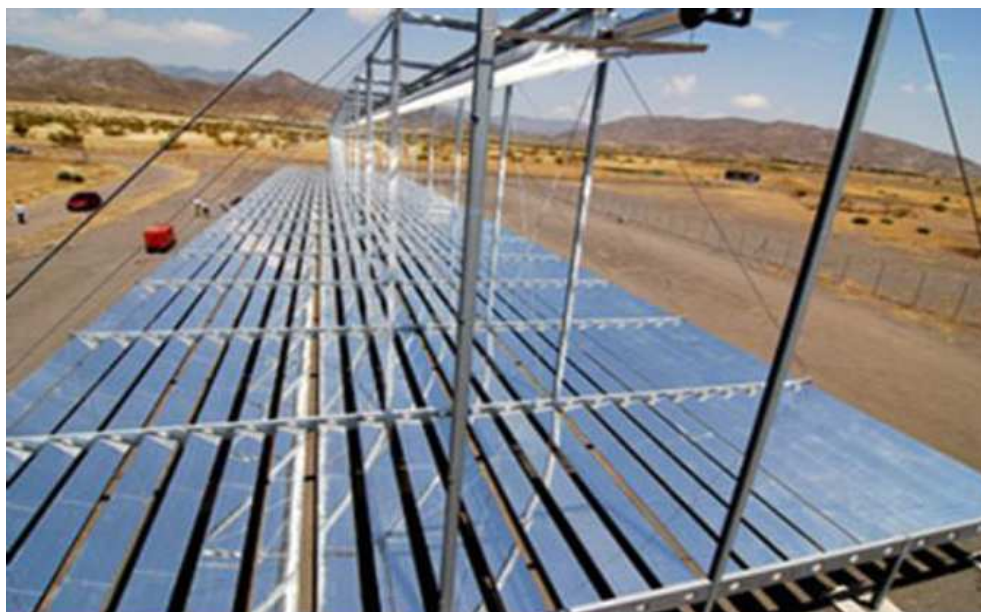
Figure 3.4 : Concentrateur à miroir de Fresnel à Almeria en Espagne [63]
