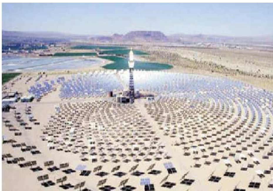
Figure 3.8 : Centrale thermique à tour (SolarTow en Californie) [66]
