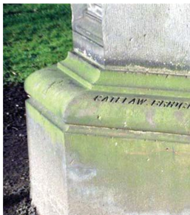
Figure 1.1: Altération par le dépôt des algues (ICOMOS 2008)
